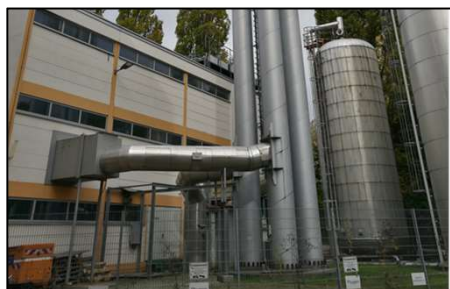
視察研修で訪れた熱供給施設。巨大なタンクから、地域に暖房用の温水が供給されています。
